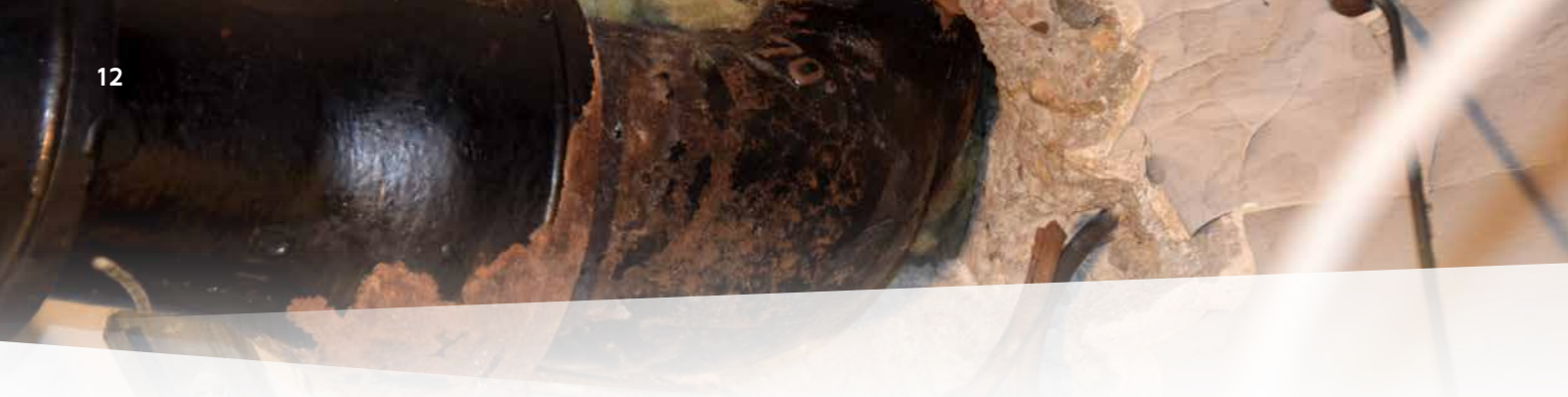
Defekte Rohre in einer Wohngruppe
