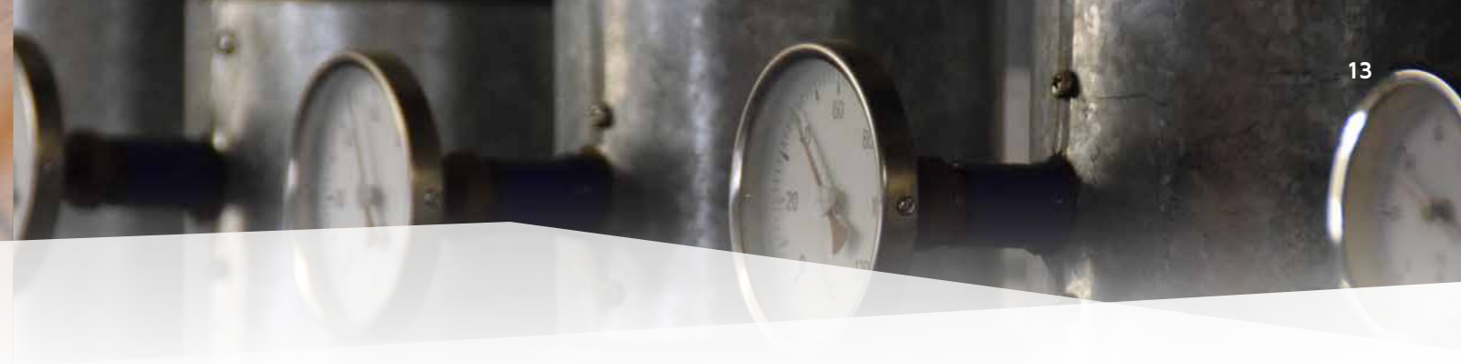
Heizungsanlage in der Sybelstraße
